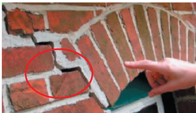
Fissure sur une maison suite à une période de sécheresse
